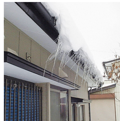
1 屋根に雪が積もると一気に軒下に落下。
